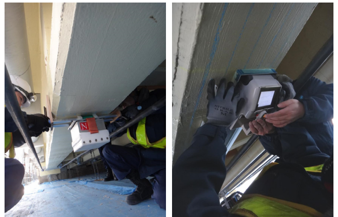
(1)磁石ユニットによる着磁 (2)磁気計測ユニットによる磁束密度測定 写真-2 鉄筋破断非破壊検査装置による実橋調査状況
