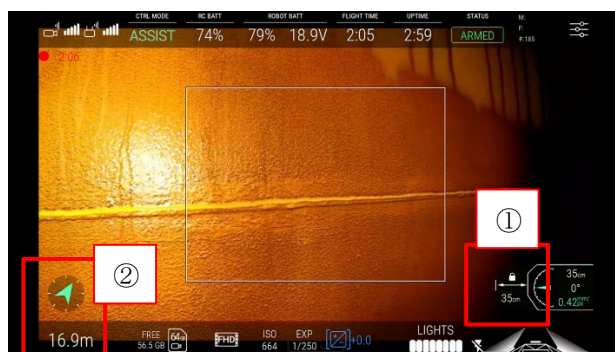
図 10 タンク内部の溶接線（①被写体との距離、②離陸地点の高度、方向を基準とした値）
