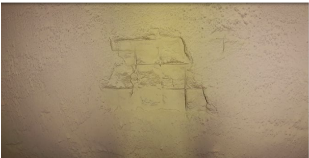
図3 煙突内面ライニングの劣化部位
