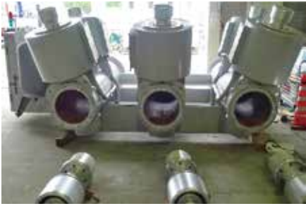
撤去遮断器の劣化調査
