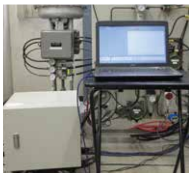
主給水制御弁動特性試験装置
