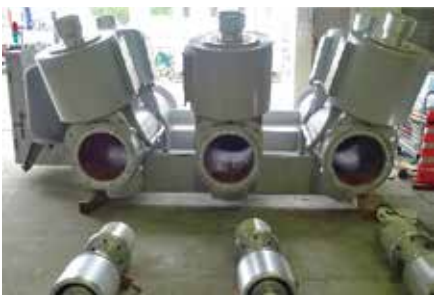
撤去遮断器の劣化調査
