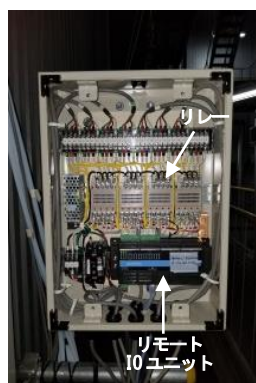
(c) 制御弁リレー箱
