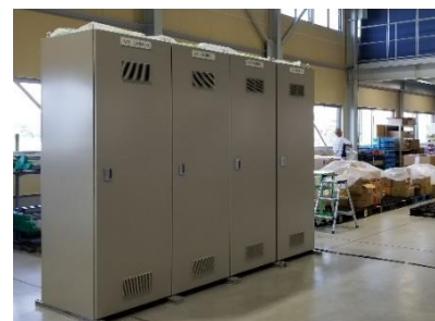
(b) ITV 制御装置
