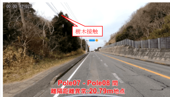
離隔距離異常発生箇所 (写真)
