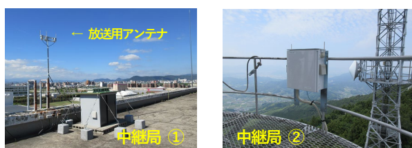
図4 中継局(放送局)の設置状況
