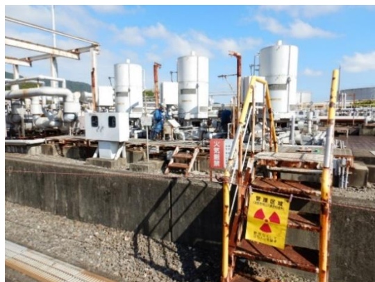
図 10 点検中の放射線管理区域明示状況
