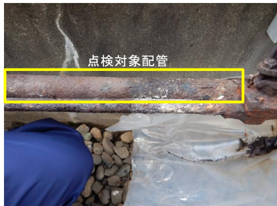
図8 配管外面腐食状況
