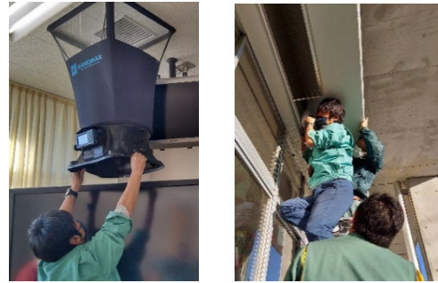
図 25 風量測定・外部給気口確認状況 全熱交換エレメント
