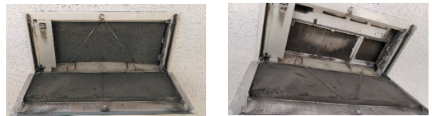
図30 清掃前の状況 (左:フィルター, 右:エレメント)
