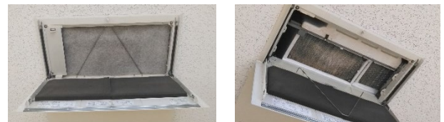
図31 清掃後の状況 (左:フィルター, 右:エレメント)
