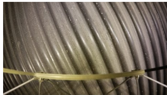
図 4 ボイラ炉底チューブ
